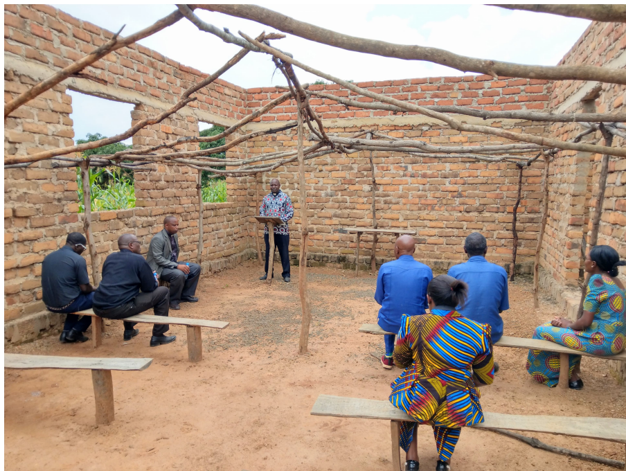
Das Dach wird kommen, sobald genug Geld zusammen ist
